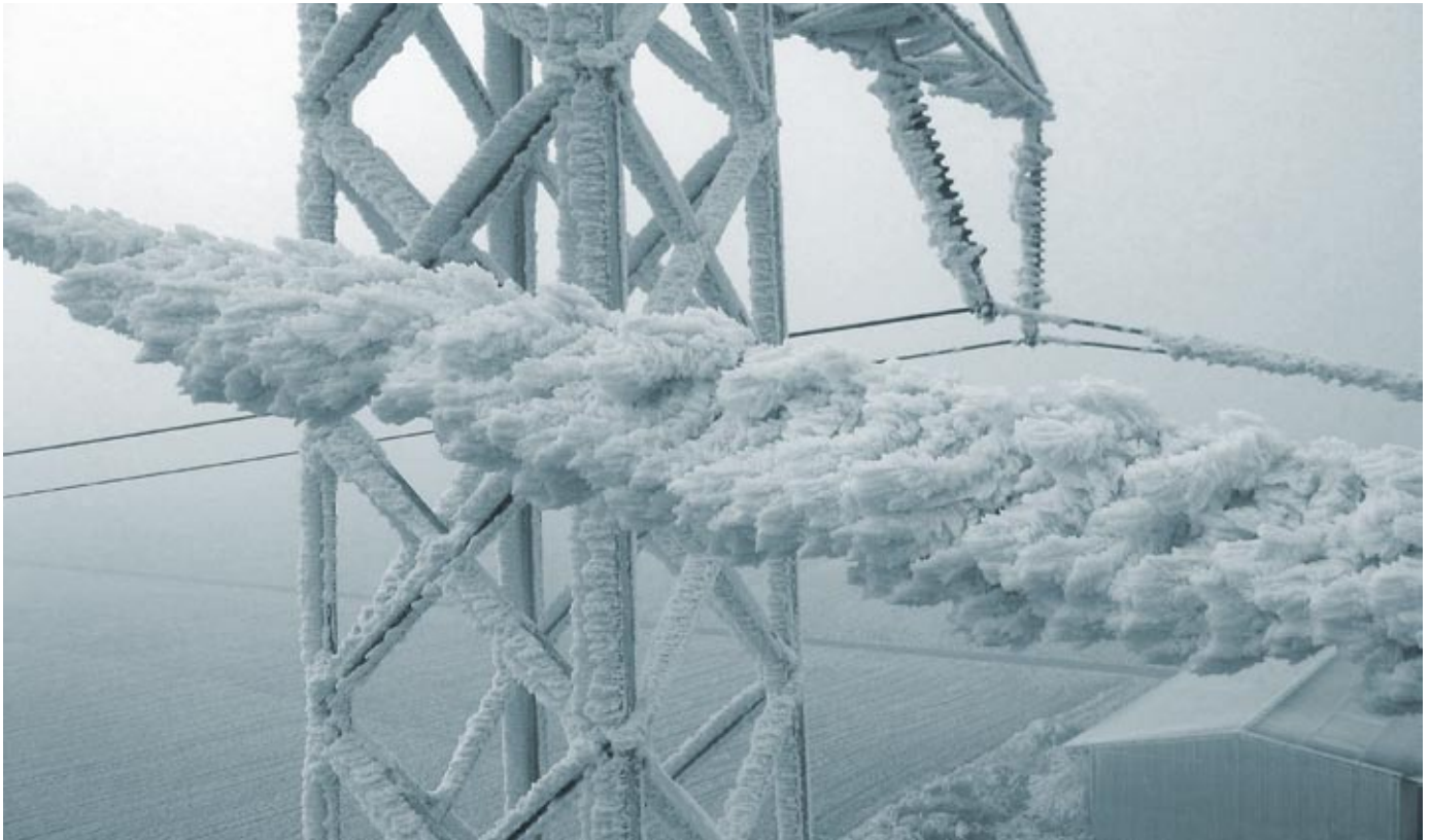
Abb. 1: Eine 110-kV-Freileitung im „Härtetest“ – hier droht akute Gefahr durch Aneisung von Raureif
