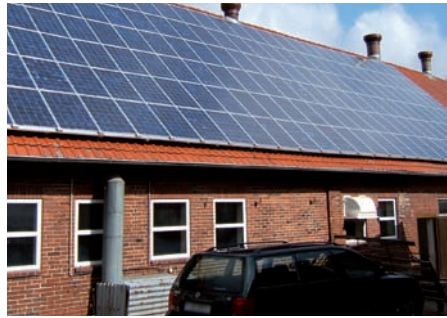
Einsatzbereite Solaranlage – gewerblich genutzt
